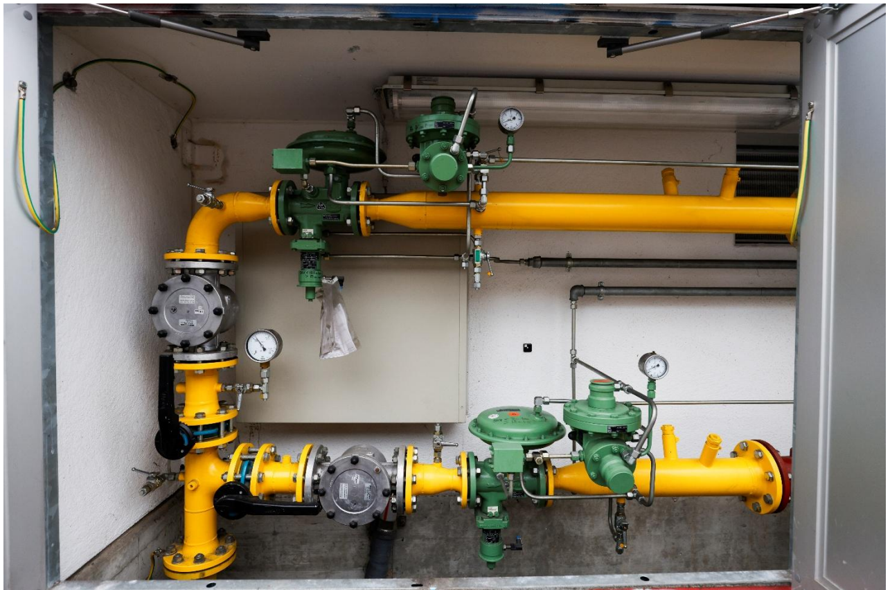
Bild: Gas-Druckreduzierstation Dorfstrasse/Rankstrasse
